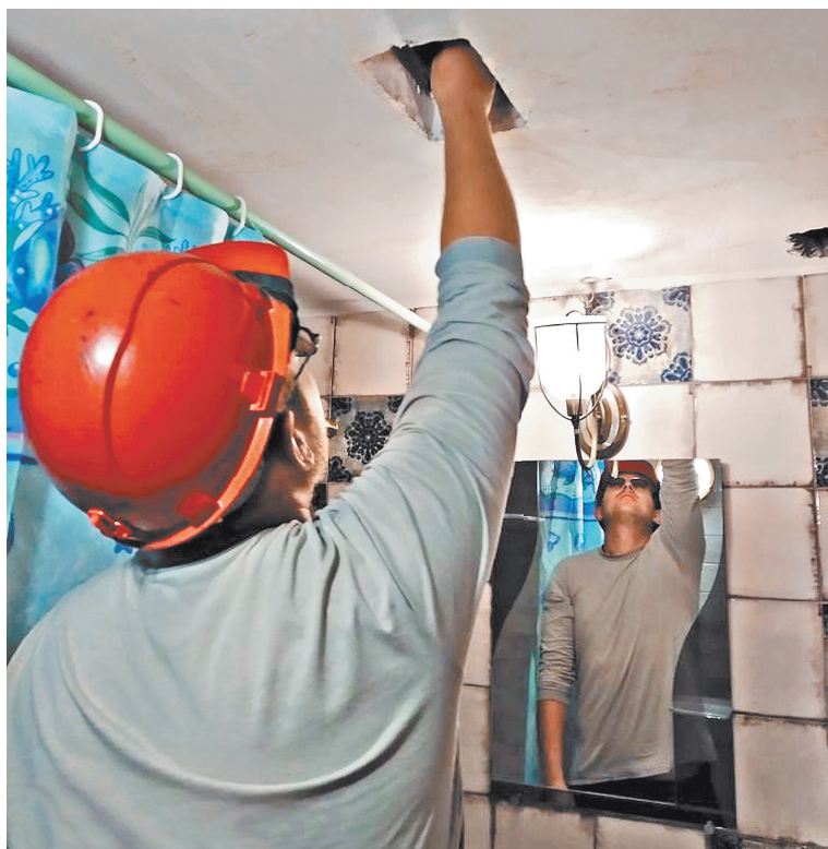
В панельном доме против всех правил не оказалось вентиляционного канала.
